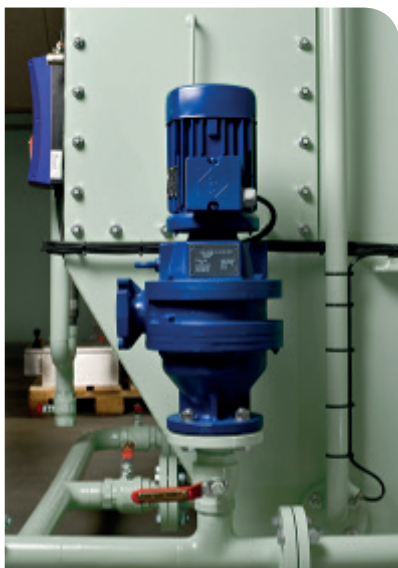
ORCUT ES an Schiffskläranlage ORCUT ES on ship purification plant
